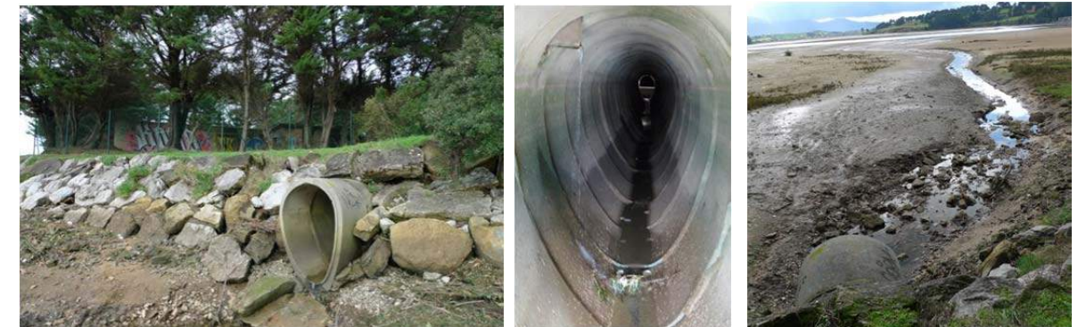
Ovoide de pluviales
