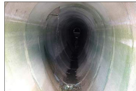
foto 9. Conducción de desagüe (interior)
