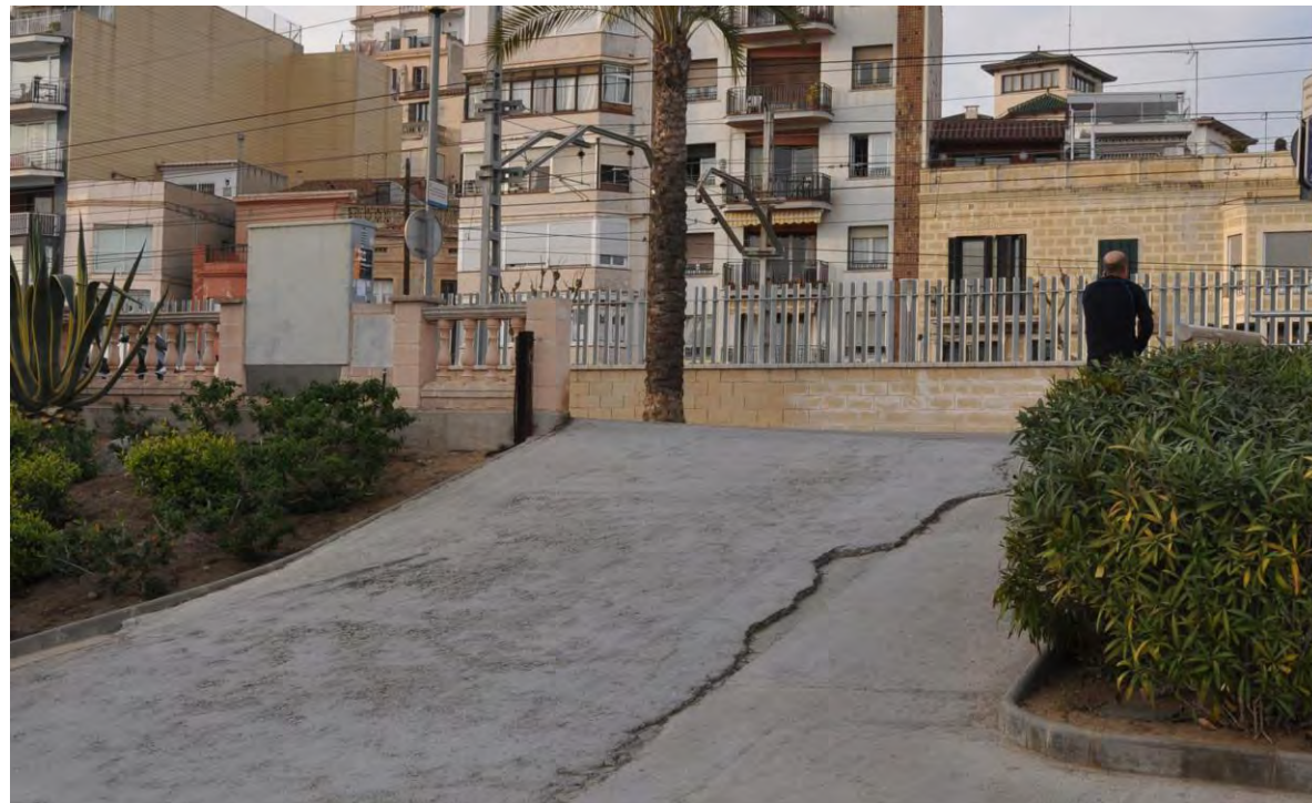
Fotografía 10.- Rampa de acceso a la playa de Ocata junto al puerto deportivo de El Masnou (Fuente: elaboración propia)
