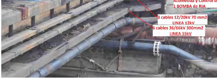
FOTO 1: INSTALACIONES LADO NORTE
